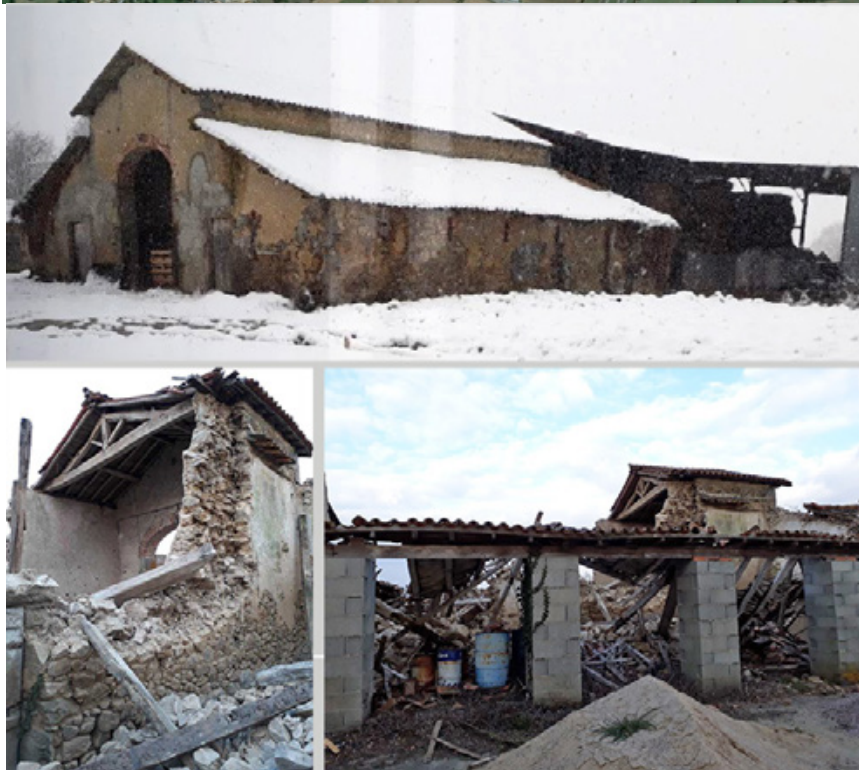
Fig. 8 – Endommagement de degré 4 au lendemain du séisme sur une grange de vulnérabilité A (commune de Chiché – lieu-dit La Lusière).
